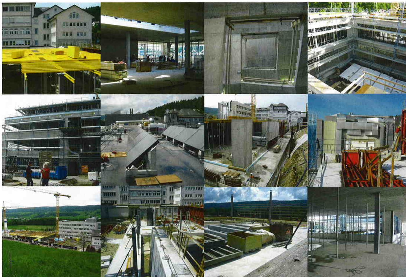
Achevés en décembre 2009, les travaux d'extensions ont généré une surface de production de plus de 9000 m 2 qui se sont ajoutés aux 16000 m 2 existants pour accompagner l'essor continu de la marque.
